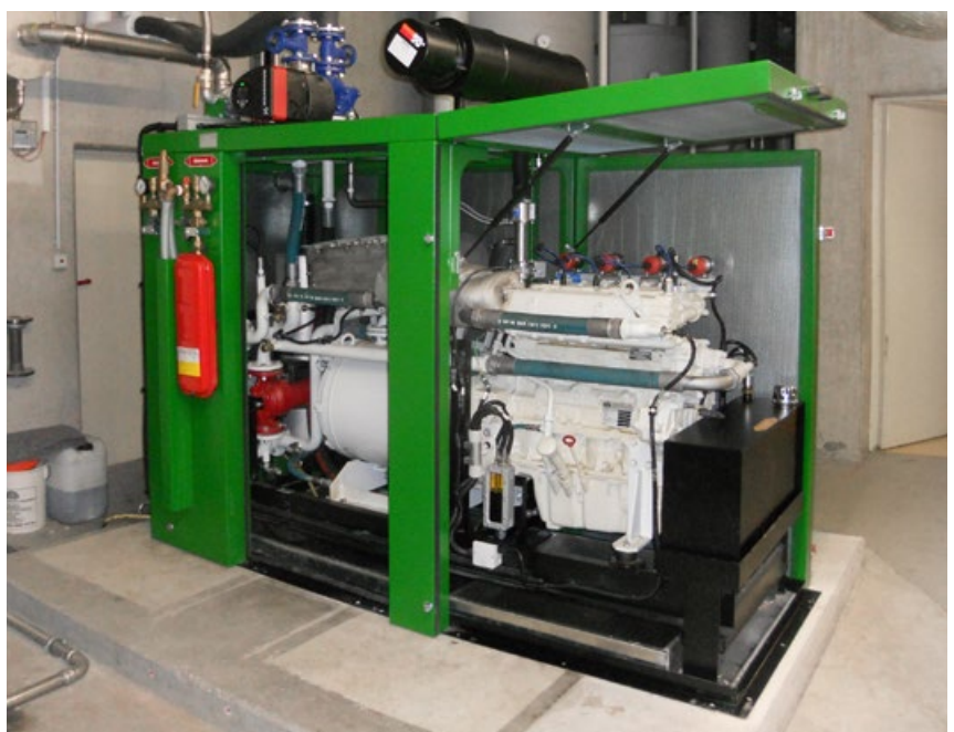
BHKW mit 50 kW el. Leistung des Herstellers 2G im Schulzentrum Galgenberg
