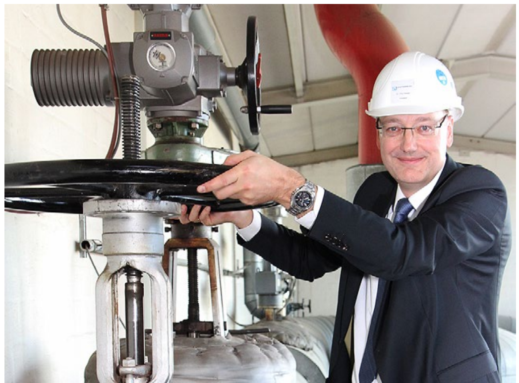
Dr. Jörg Teupen, Vorstand Technik und Personal Stadtwerke Kiel AG, beendet die Dampfversorgung und schließt somit die Umstellung auf das effizientere Heizwasser ab.
