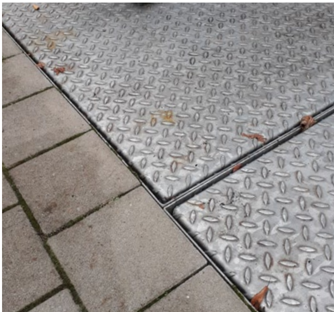
Abbildung 11: Gehwegplattform eingelassen; Quelle: Stadtreinigung Hamburg
