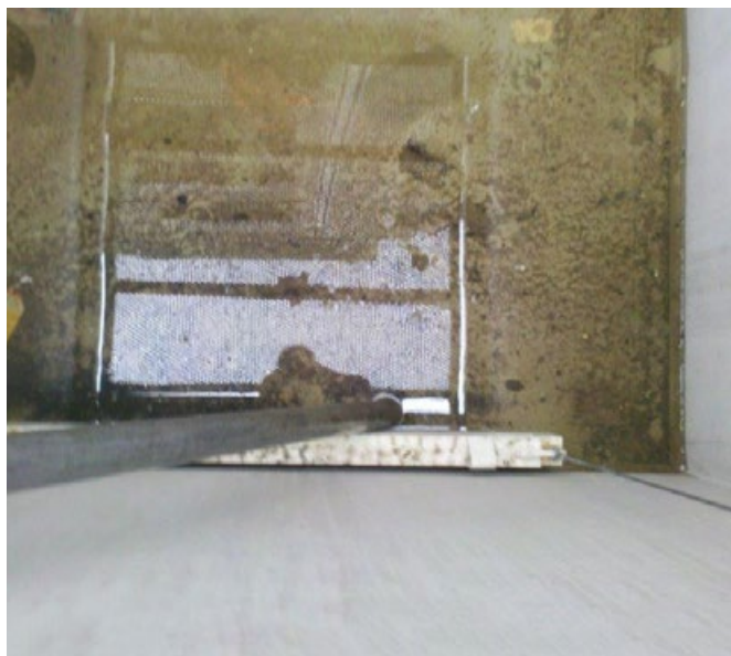
Abbildung 34: Beschädigung des Bodenbelags durch Stützfuß; Quelle: AWB Köln GmbH
