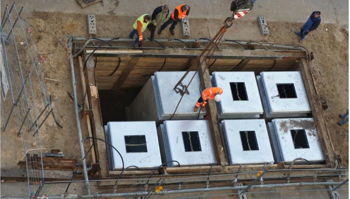
Abbildung 15: Schacht, Quelle: BSR
