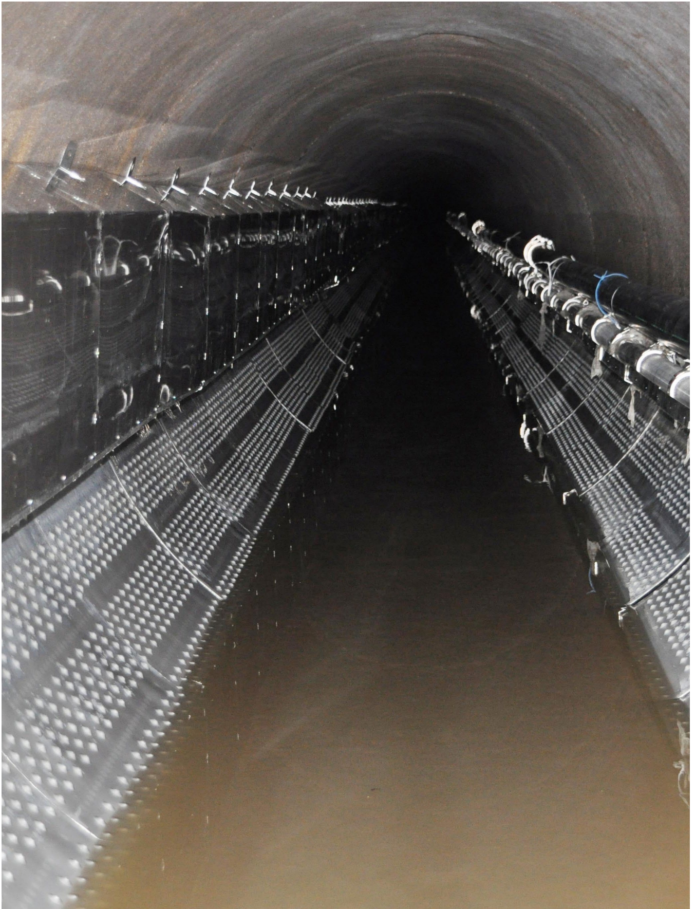
Abwasserwärmeprojekt des OÖWW am Alten Stadthafen: Blick in den Mischwasserkanal mit einem Durchmesser von 1,50 Meter. (Die Installation der Wärmetauscher ist noch nicht abgeschlossen.)
