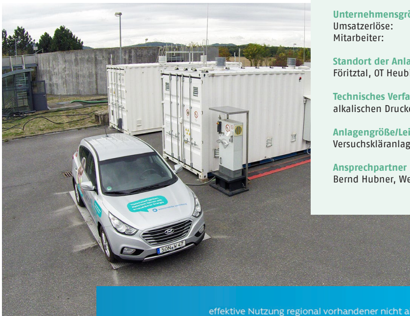
Container Elektrolyseur und Tankstelle, © Wasserwerke Sonneberg
