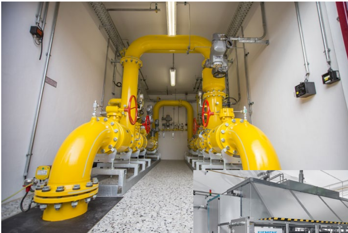
Einweihung der Power-to-Gas-Anlage Quelle: Stadtwerk Haßfurt GmbH
