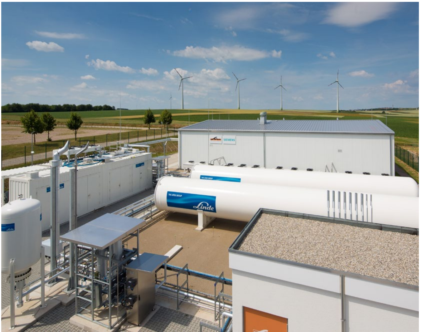
Power-to-Gas-Anlage neben dem Mainzer Messegelände Quelle: Mainzer Stadtwerke AG, © Erich Malter
