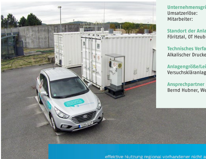
Container Elektrolyseur und Tankstelle © Wasserwerke Sonneberg
